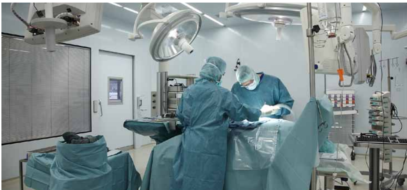
OP-Saal des Universitätsklinikum Tübingen mit Imtech-Technologie.
